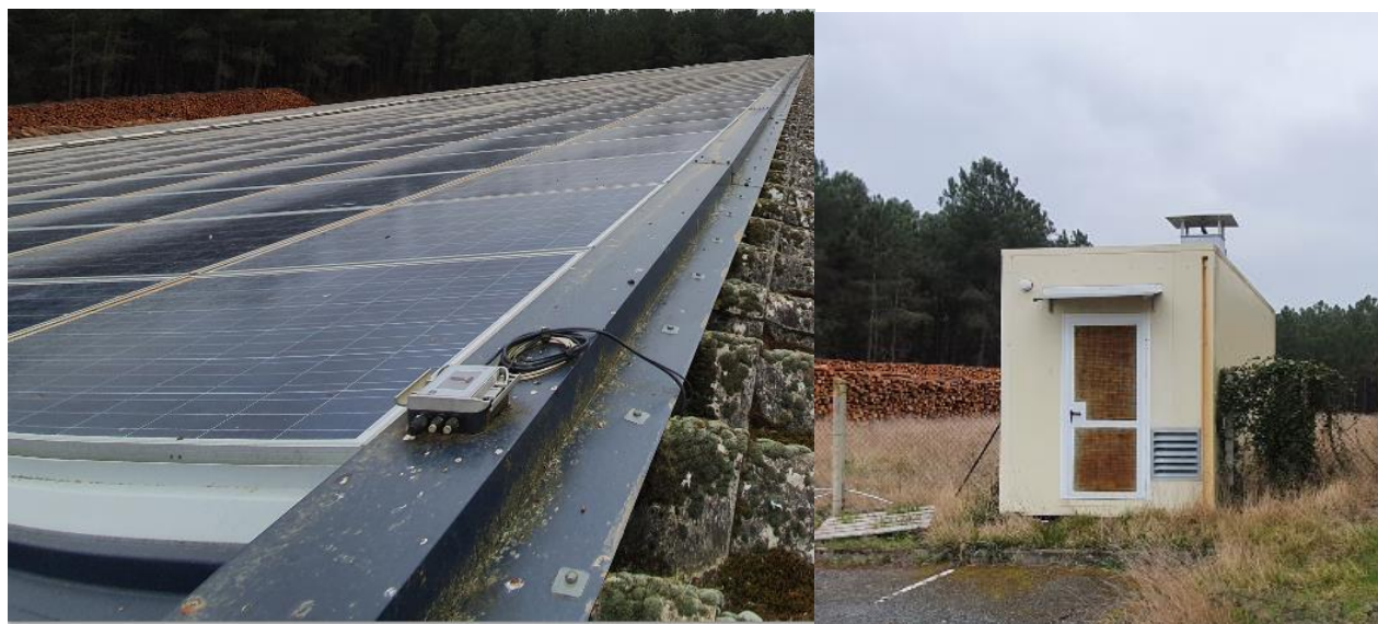
PHOTO 1 : VUE DES PANNEAUX PHOTOVOLTAÏQUES EXISTANT ET DU LOCAL TECHNIQUE OU SONT IMPLANTES LES ONDULEURS.
