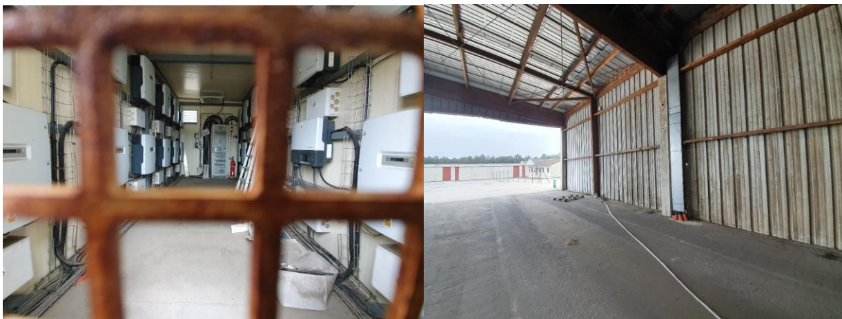
PHOTO 2 : VUE DE L'INTERIEUR DU LOCAL TECHNIQUE DES ONDULEURS ET DU CHEMIN DE CABLES EN FAÇADE
