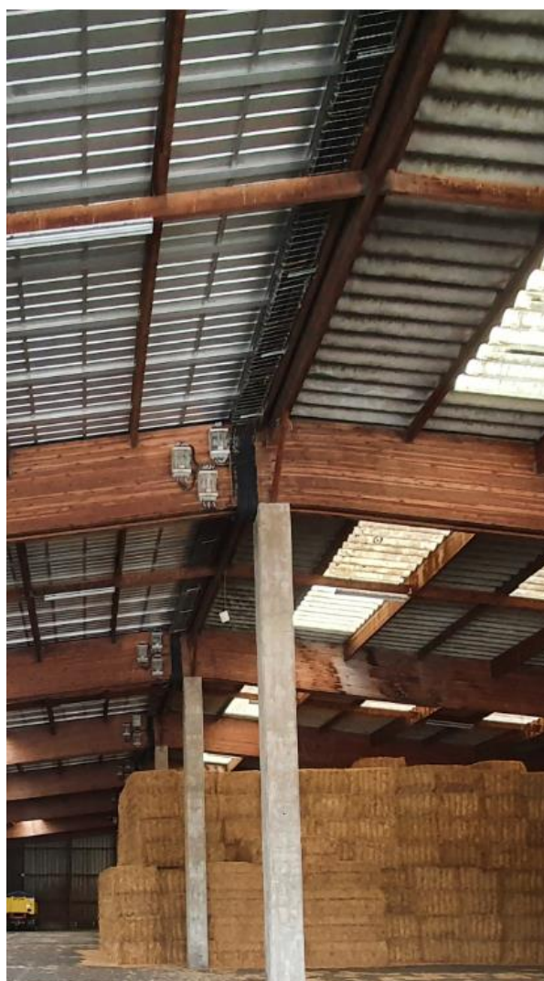
PHOTO 3 : PASSAGE DES CABLES DANS UN CHEMIN DE CABLE ET BOITIERS DE RACCORDEMENT SOUS TOITURE
